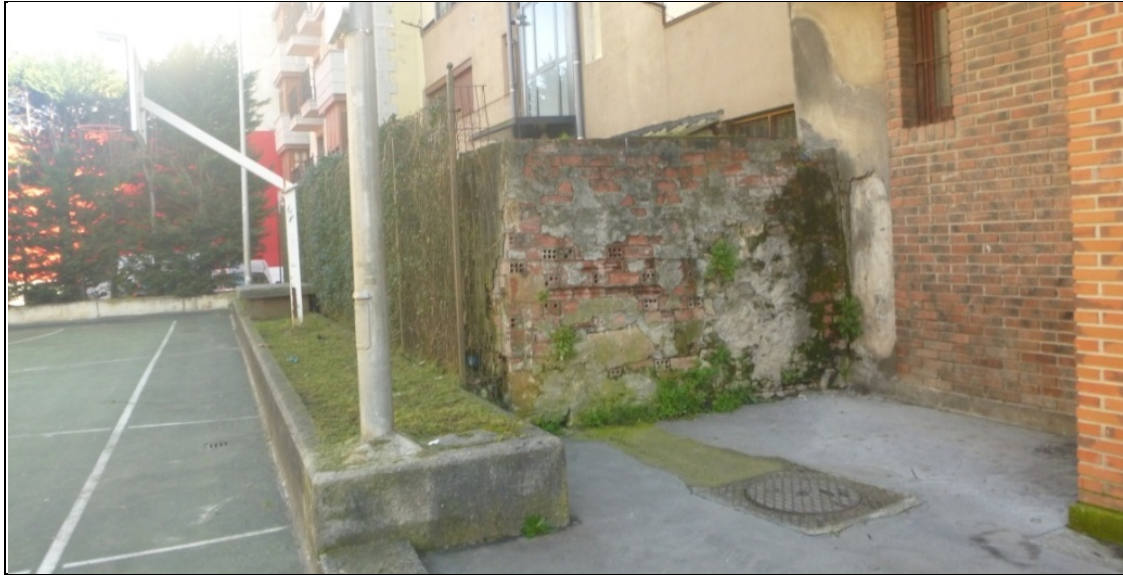
Construcción anexa y cierre de Mitarte 12 que invade el espacio de uso público
